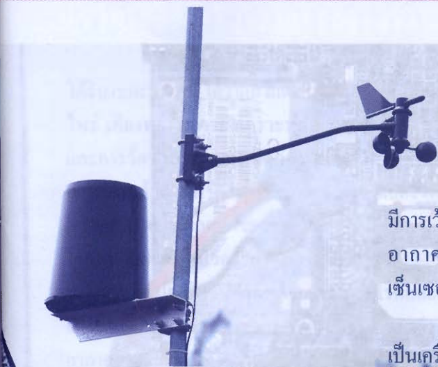
เครื่องตรวจวัดปริมาณน้ำฝนและเครื่องวัดทิศทางและความเร็วลม ติดตั้งไว้ภายนอกโรงเรียนกล้วยไม้ ม.เกษตรกำแพงแสน
